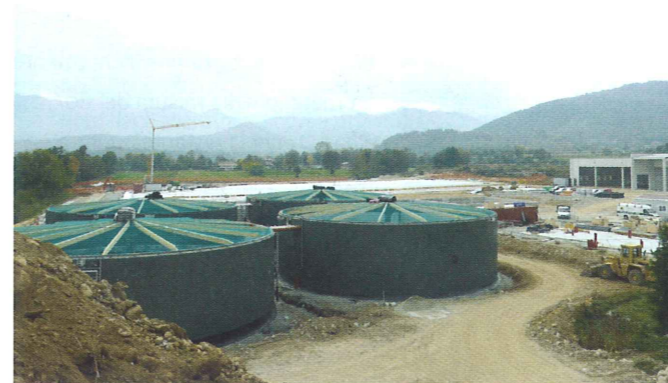
Particolare dei digestori.
